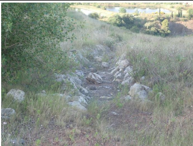
Illustration 29 : Caniveau de gestion des eaux encombré par des blocs effondrés (ou charriés)
