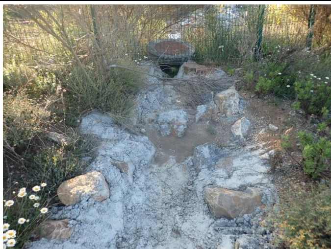
Illustration 7 : Légère accumulation de sédiments dans l'entonnement en amont de la station de traitement
