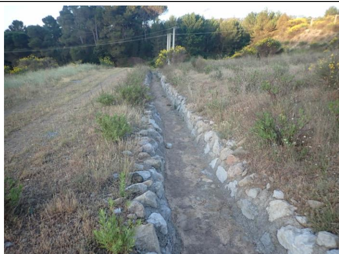
Illustration 20 : Caniveau d'acheminement des eaux pluviales en bon état de fonctionnement
