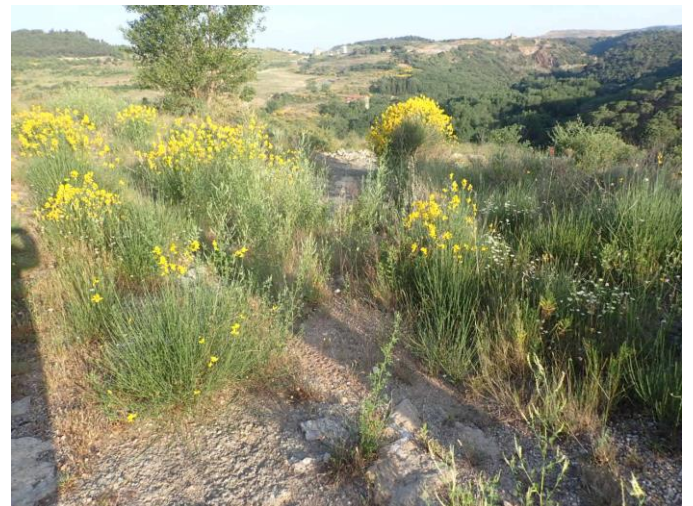
Illustration 28 : Caniveau de gestion des eaux et zone de réception en enrochement, encombré par la végétation
