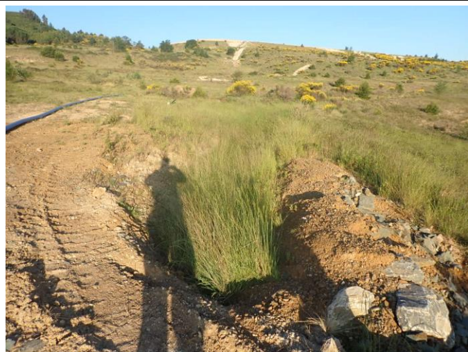
Illustration 9 : Merlon de protection dégradé en amont de la mare B2 et terrassements pour passage d'engins
