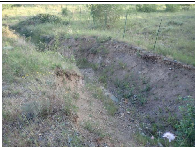
Illustration 36 : Fossé drainant en aval du portail d'accès Nord-Est, raviné
