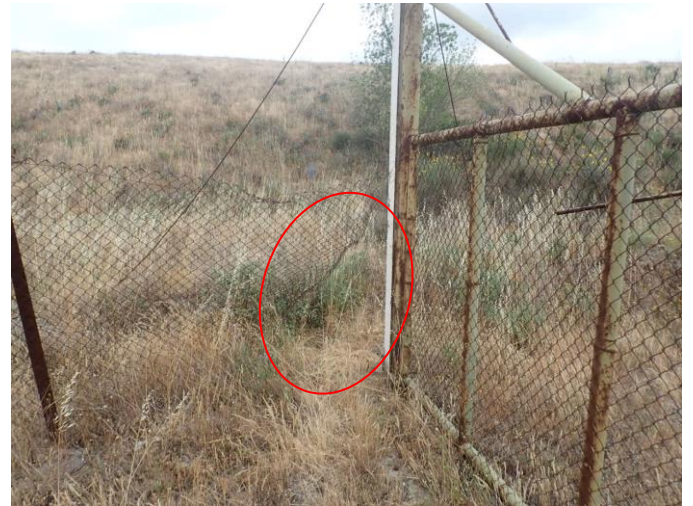
Illustration 40 : Grillage vandalisé au droit de l'ancien portail d'accès (résolu)
