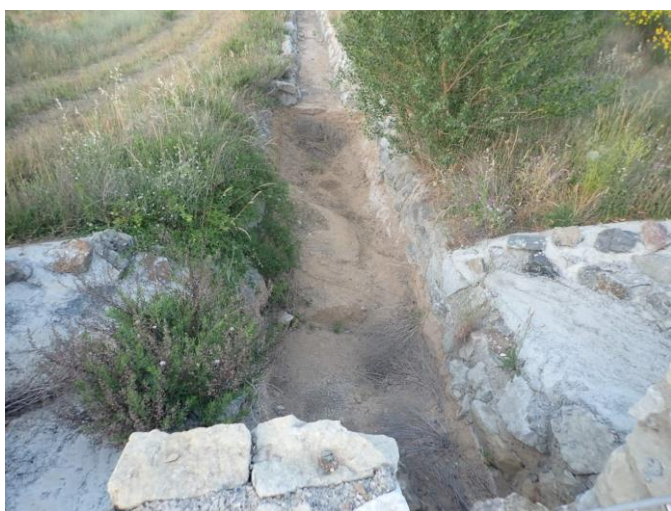
Illustration 17 : Accumulation de sédiments dans le bassin aval du dégrileur
